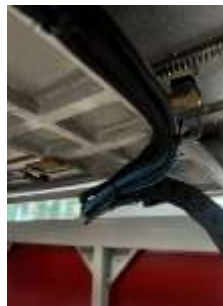
(ข) การติดตั้งลิ้มิตสวิตช์เพื่อ จำกัดขอบเขตแกน Y
