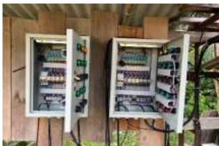
(ก) ตู้ควบคุมการทำงานระบบดูแลแปลงปลูกด้วย IoT
